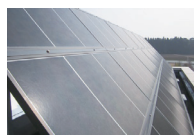
埼玉ロジスティクスセンター ／太陽光発電システム
