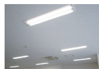
ベストロジ熊本/ LED直管蛍光灯
