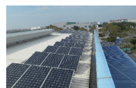
太陽光発電システム
