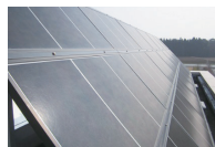
埼玉ロジスティクスセンター ／太陽光発電システム
