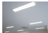
ベストロジ熊本/ LED直管蛍光灯
