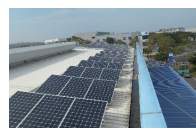
太陽光発電システム
